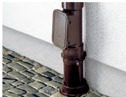
Collegamento del sistema alla rete fognaria
