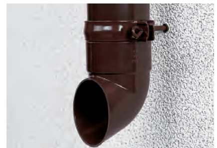
Scarico delle acque piovane
